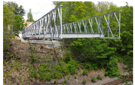
Aucun matériel de levage lourd : le pont modulaire à panneaux Algonquin s'élève en porte-à-faux au-dessus de la voie ferrée, sur laquelle continuent de circuler les trains
